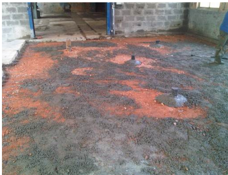
Aperçu de l'excavation remblayée, vue des têtes des aiguilles d'injection et piézomètre
